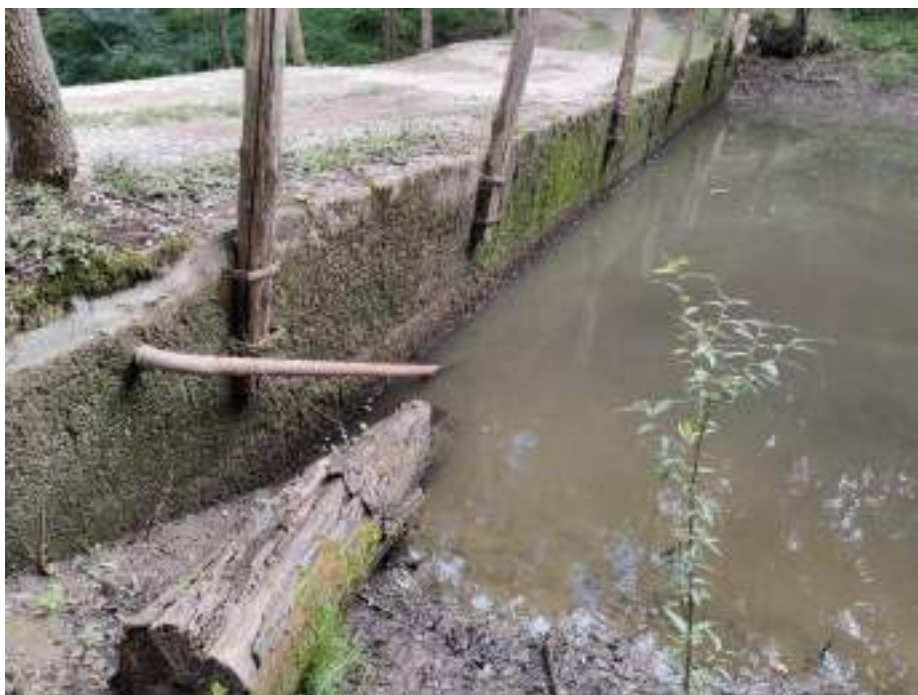
Detall de la resclosa i la rampa de sortida d'amfibis.
